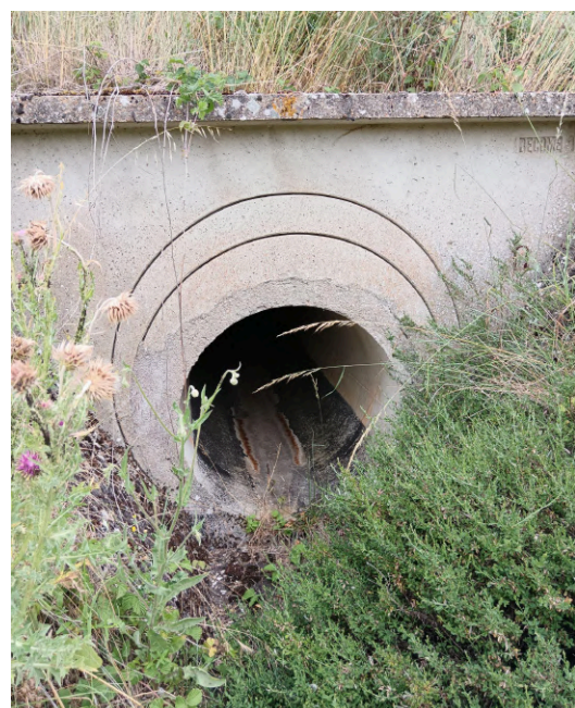
Figure 17 : Photographie d'une buse sur une portion de l'autoroute A75 sur la zone d'étude pouvant servir de passage pour les amphibiens - Photo: Devanne, juin 2024.
